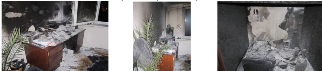
Požár bytu v 8 NP, Pelhřimov, 3.2.2014.
