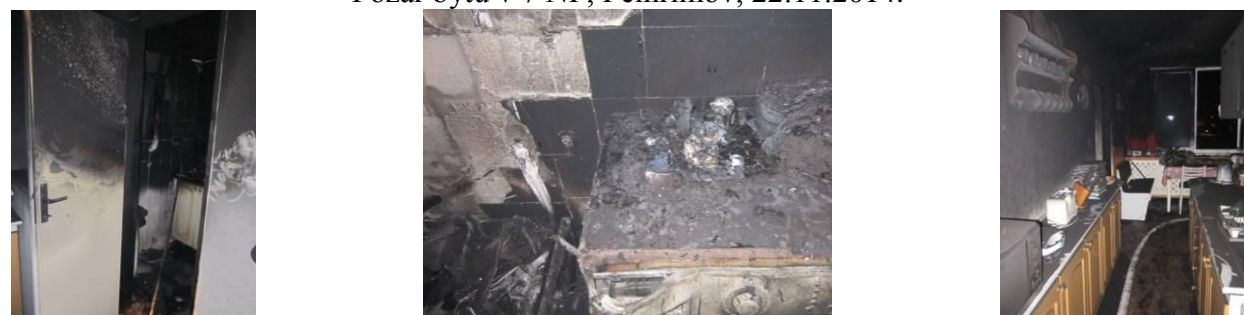
Požár bytu v 7 NP, Pelhřimov, 22.11.2014.
