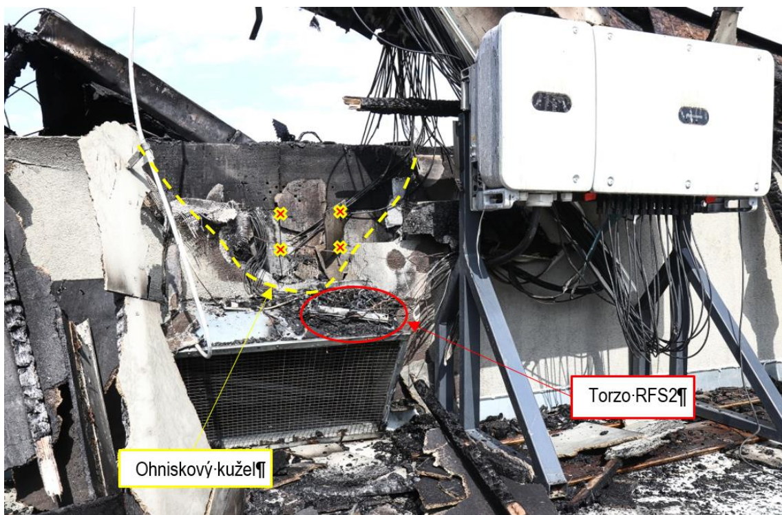
Obr. 12 Pohled na kriminalistické ohnisko požáru s vyznačeným ohniskovým příznakem a pozicí vrutů
