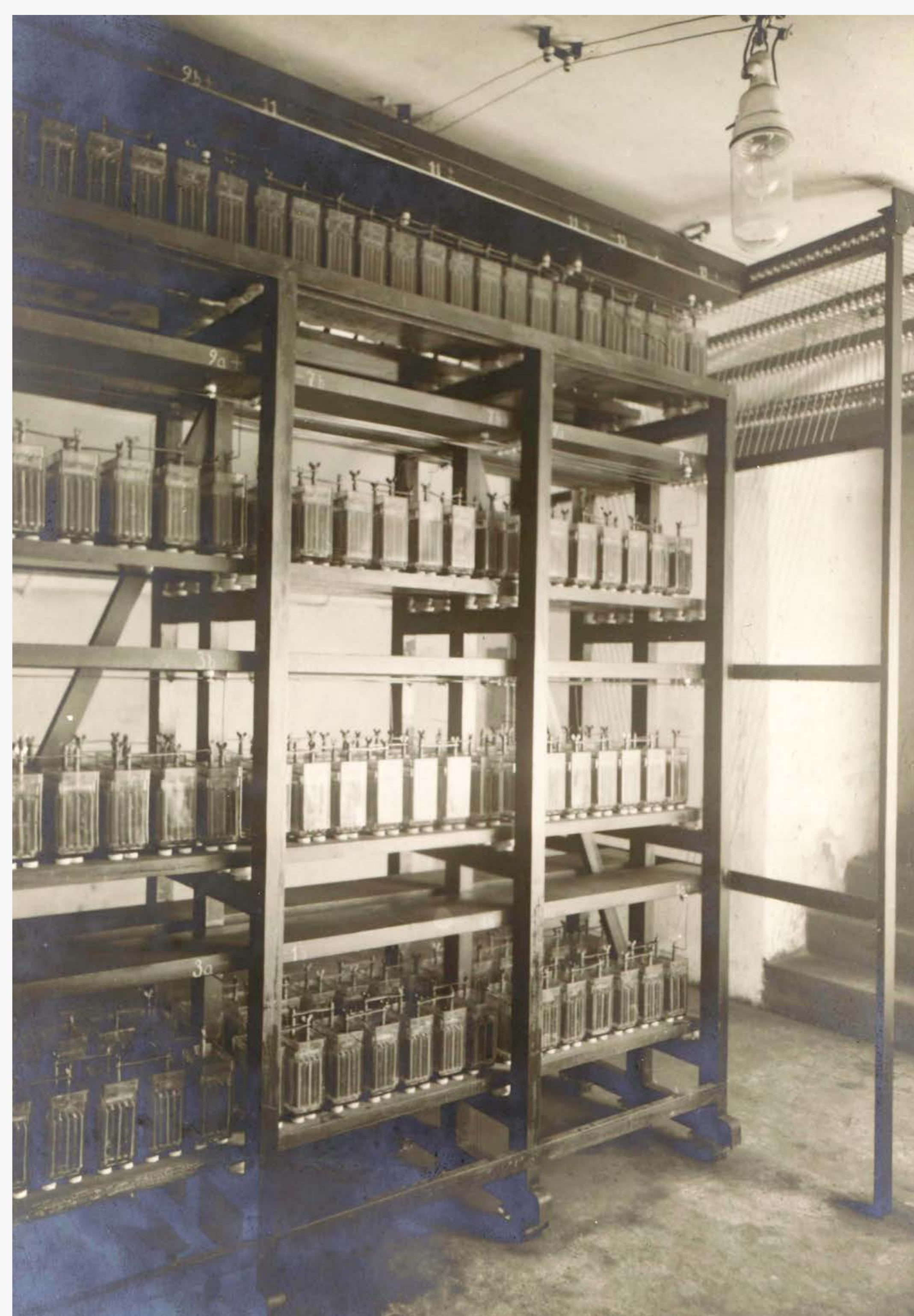
Akumulátorová baterie z roku 1922
