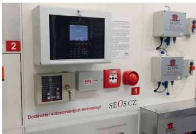
Ústředna zařízení elektrické požární signalizace
