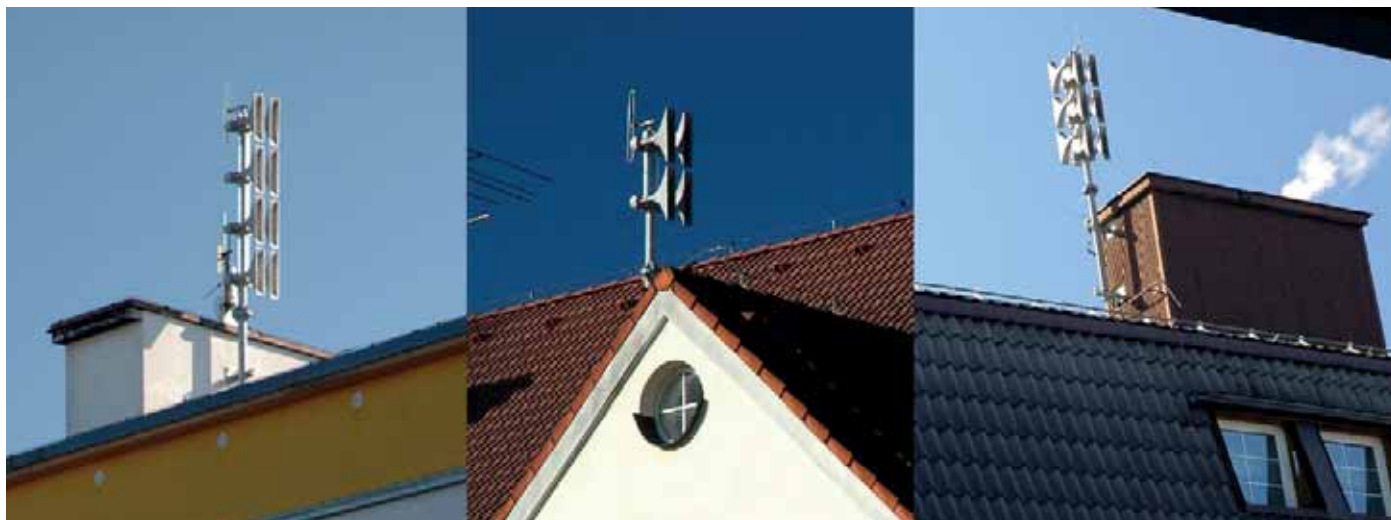
Obrázek 2 Instalované koncové prvky varování
