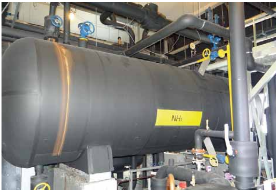
Obrázek 1 Strojovna chlazení zimního stadionu
