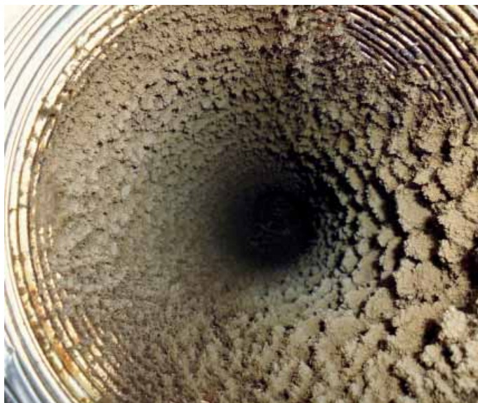
Nános hořlavého prachu a nečistot v komínové vložce pro spotřebiči na zemní plyn
