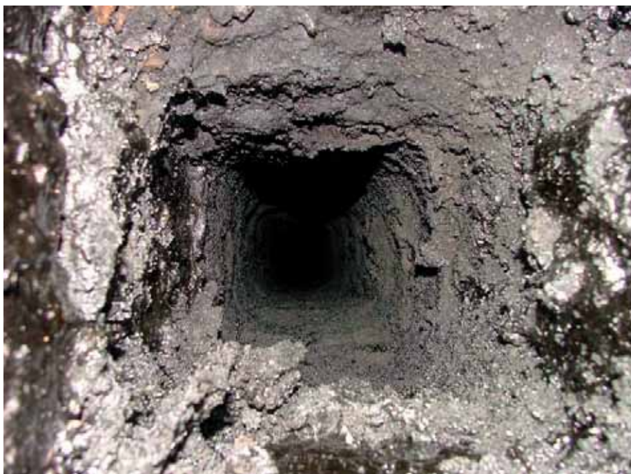
Zadehtovaný komín – důsledek zanedbaného pravidelného čištění a kontroly
