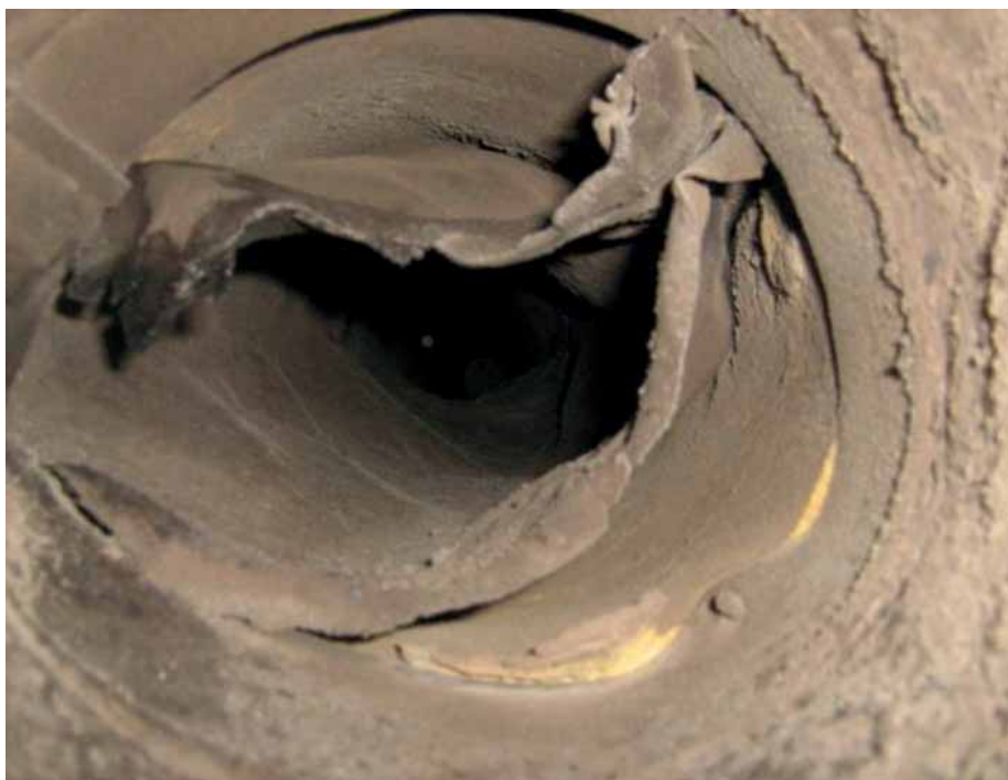
Komín pro spotřebič na zemní plyn – deformace komínových vložek po požáru nečistot v komíně
