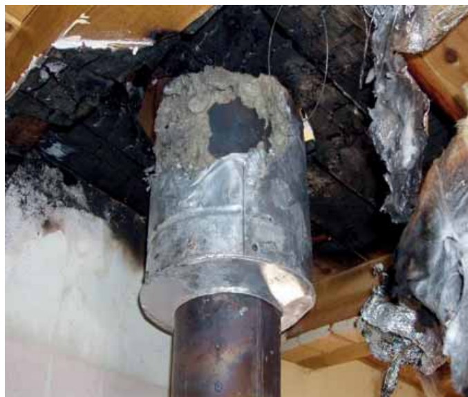
Požár střešní konstrukce – nesprávně provedený svislý kouřovod s funkcí komína
