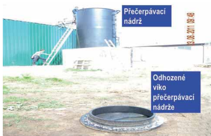
Obr. 5 Odhozené víko přečerpávací nádrže po výbuchu směsi
