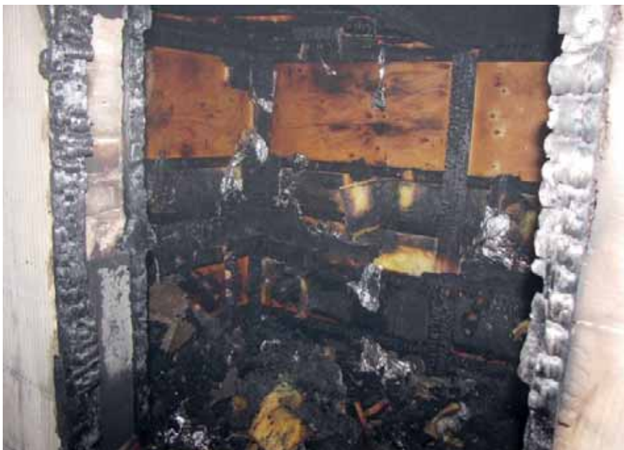
Pohled do vyhořelé sauny nemocnice v době lokalizace požáru
