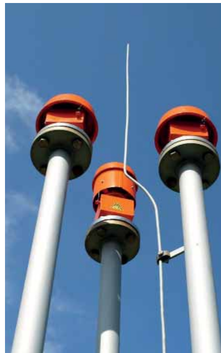
Odvětrávání podzemní nádrže na čerpací stanici PHM
