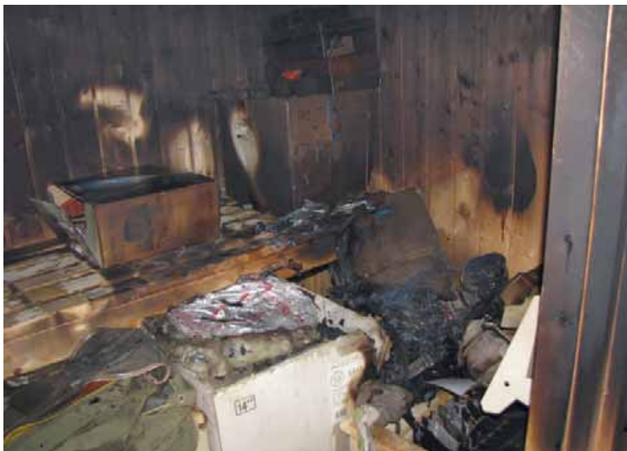
Pohled do vyhořelé saunovací místnosti v rodinném domě
