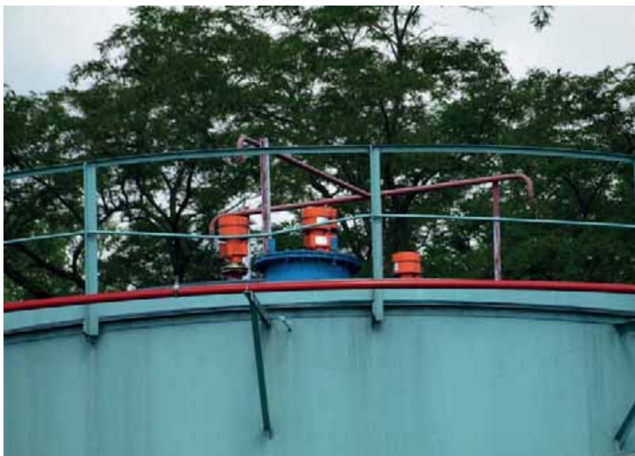
Odvětrávání nadzemní nádrže
