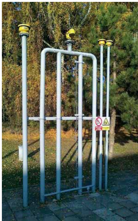
Odvětrávání podzemní nádrže na čerpací stanici PHM
