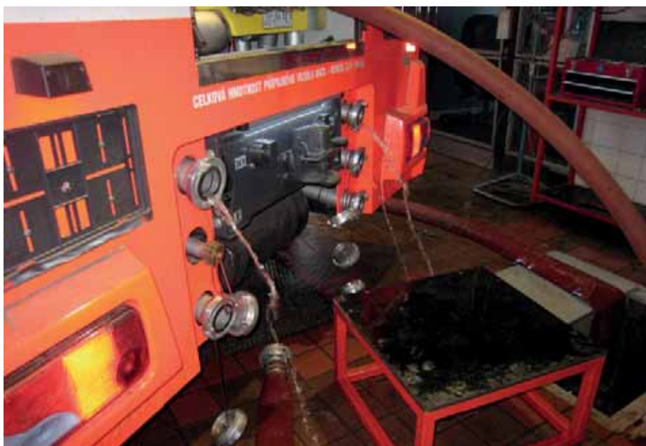
Netěsnosti ventilů výtlačků při tlakové zkoušce
