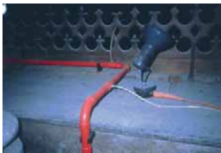
Obr. 3 Příklad nenápadného umístění nasávacího potrubí podél říms a ochozů. Zdroj: [6]
