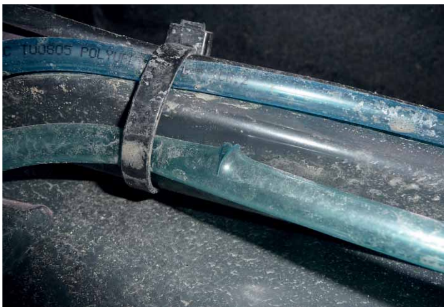
Prasklá hadice rozvodu vzduchu
