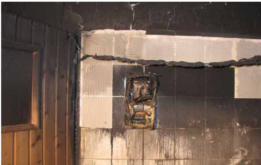
Regulátor provozu sauny byl poškozen sálavým teplem
