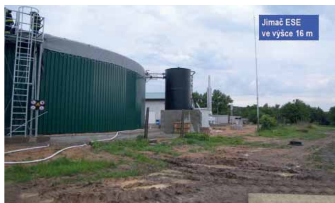
Obr. 7 Celkový pohled na umístění jímáče ESE, který je vzdálen 13 m od okraje fermentoru
