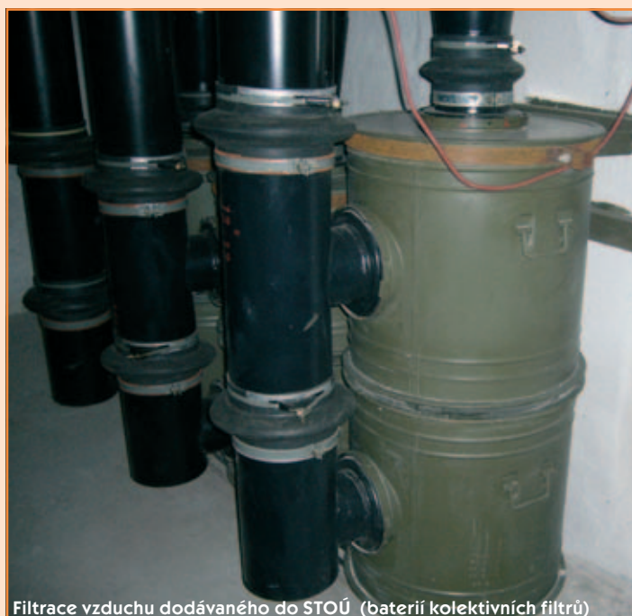
Filtrace vzduchu dodávaného do STOÚ (baterií kolektivních filtrů)
