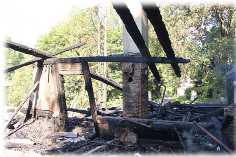
Obrázek 21 - podkroví....pohled ze severozápadního rohu, nad kriminalistickým ohniskem požáru
