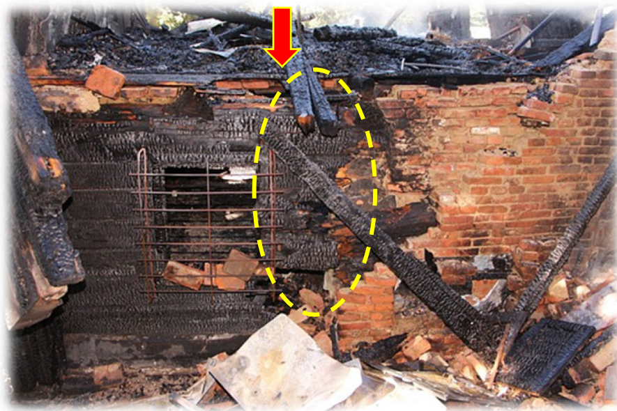
Obrázek 7 - celkový pohled na dům ze severní strany....elipsa označuje místo, kde došlo k prohoření dřevěné stěny nad kriminalistickým ohniskem požáru a šipka označuje místo prohoření stropu do podkroví
