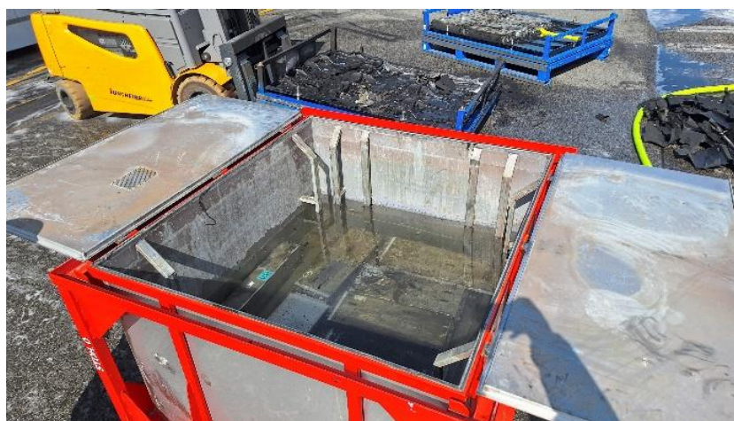
Obrázek 30 – Zaplavené nestabilní moduly po požáru
