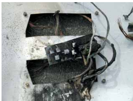
Detail ohniska vzniku požáru
