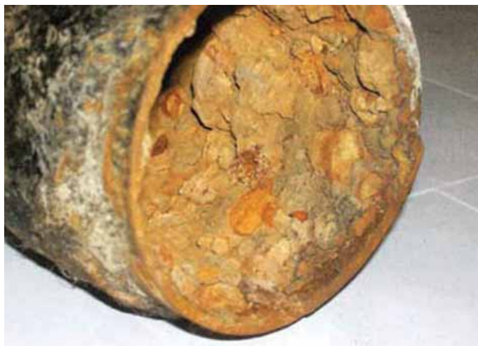
Stav potrubí sprinklerového zařízení po 25 letech
