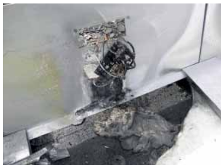
Ohnisko vzniku požáru
