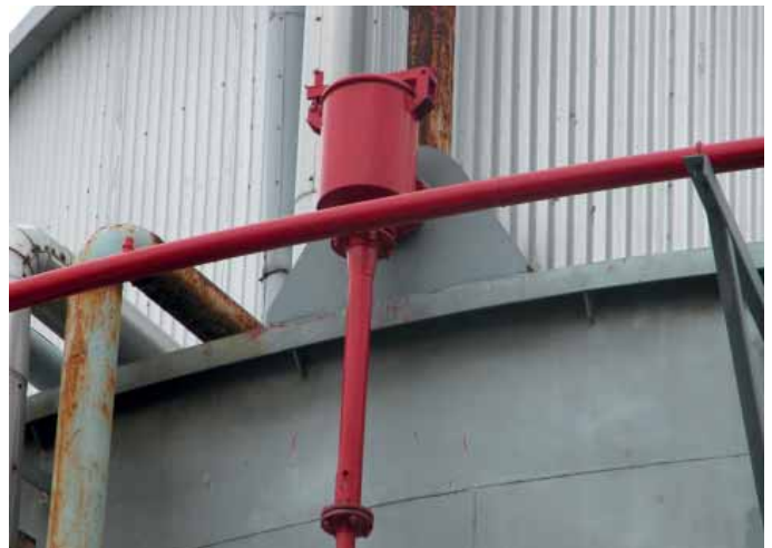
Ochrana záchytné jímky skladovací nádrže pěnovým SHZ na těžkou pěnu - detail pěnového hrnce a směšovací trubky
