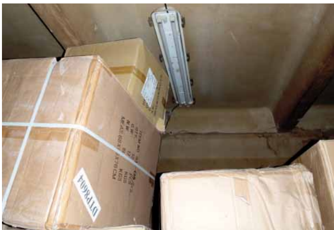
Fatální porušení způsobu skladování bez šance pro sprinklerovou ochranu
