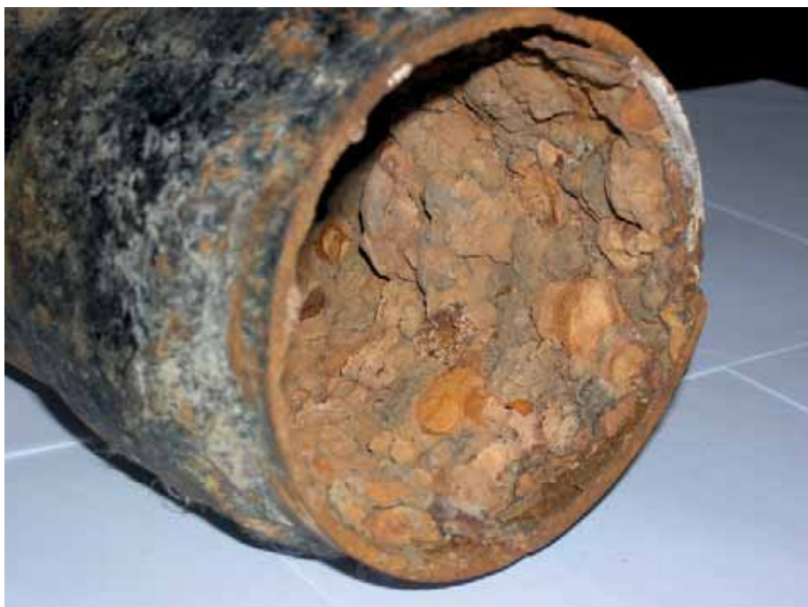
Obr. 6 Potrubí se sníženým průtokovým profilem
