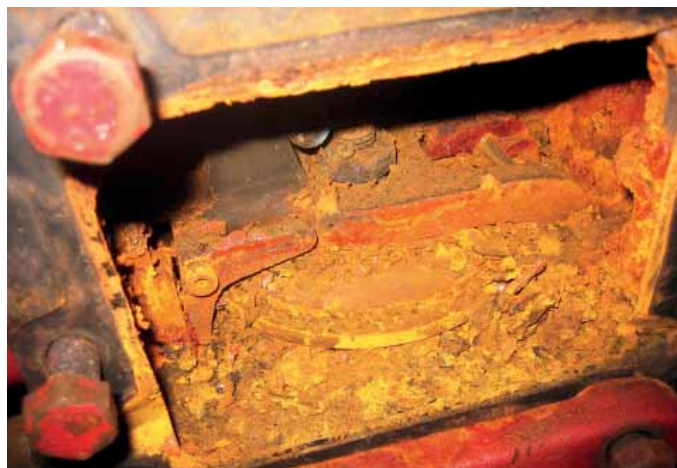
Stav řídicího ventilu u nekontrolovaného sprinklerového zařízení
