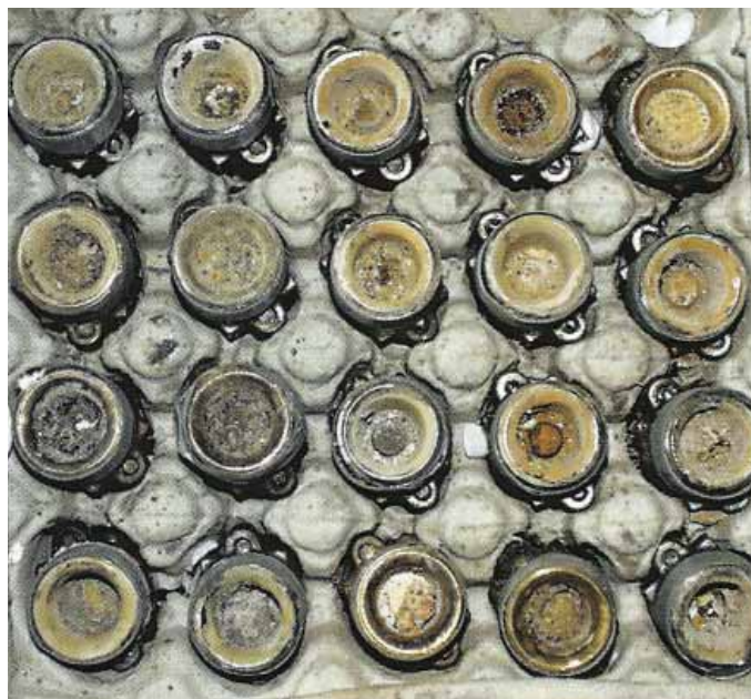
Namátkově odebraných 20 sprinklerů v rámci kontroly sprinklerové instalace staré 25 let - většina obsahuje usazeniny ovlivňující průtok, a tím i účinnost hašení
