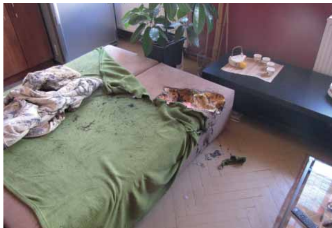
Vyhoření postele, kde probíhalo plamenné hoření
