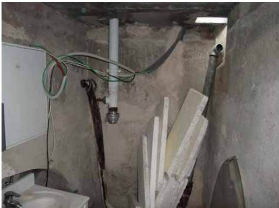
Nezavodněné požární potrubí
