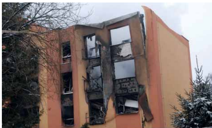
Výbuch plynu v bytovém domě ve Frenštátě pod Radhoštěm [2]
