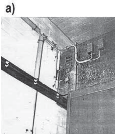
Obr. 3 Požární klapky ve ventilačních kanálech
