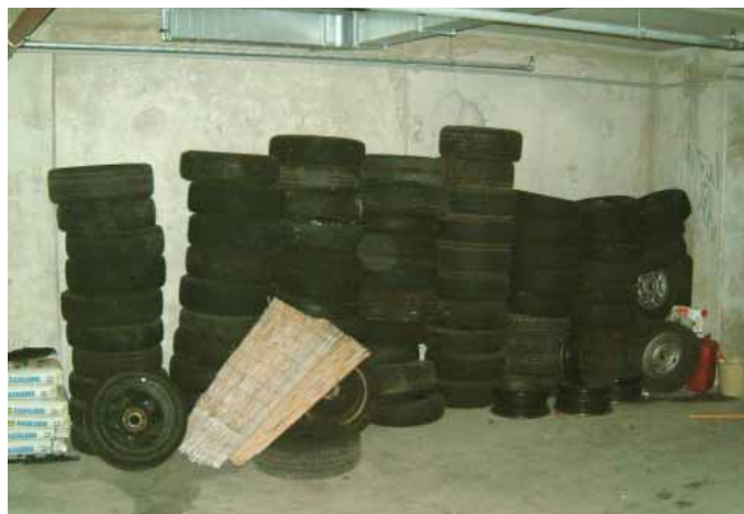
Změna skladované komodity, pro kterou nebyla sprinklerová ochrana navržena
