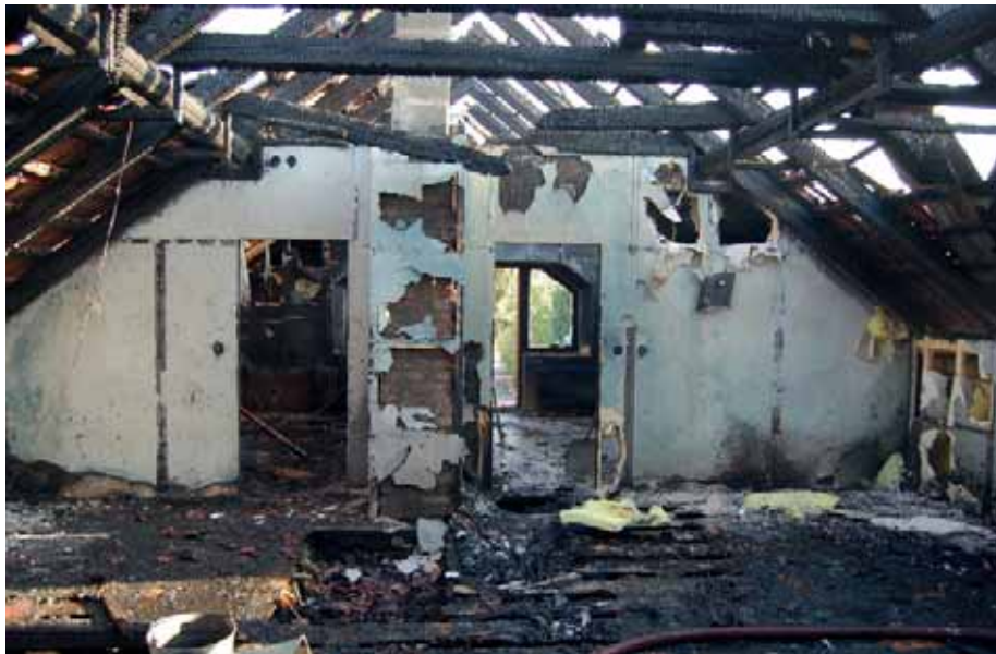
Objekt po požáru vzniklého od nesprávně instalovaného svítidla
