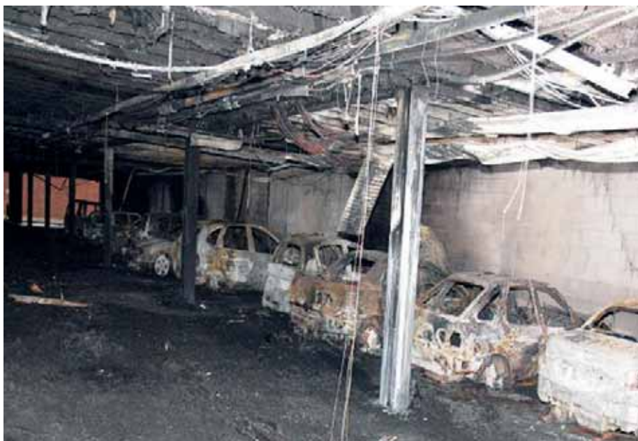
Požár podzemních hromadných garáží v Bristolu v roce 2006
